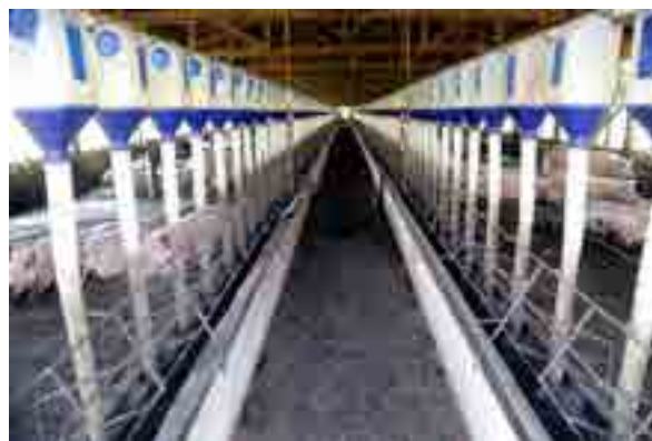
Foto 1 – Sistema automático para distribuir ração na gestação FONTE: ABCS
